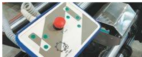
Выносной пульт и газовая горелка
